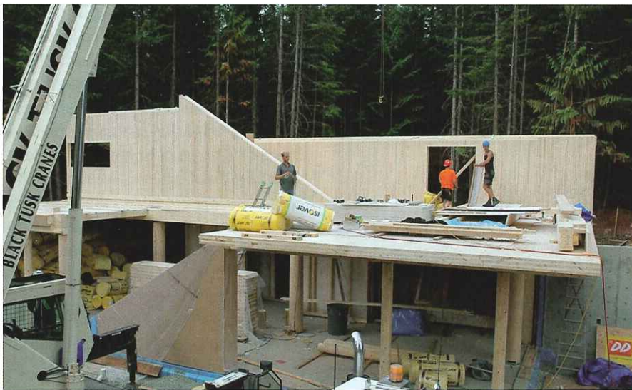
Österreichische Zimmerer bauen die Massivholzelemente, die in Österreich vorgefertigt wurden, in Kanada zusammen. Die präzise Herstellung machte eine reibungslose Montage möglich. Eine Nachkorrektur in Kanada wäre nur mit sehr viel Aufwand möglich gewesen.
